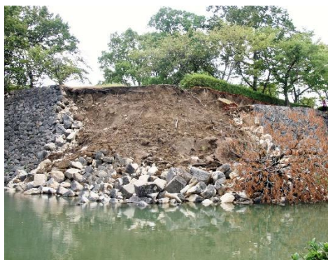
石垣が崩れた八代城跡
